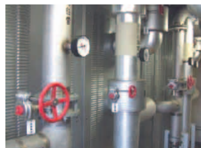
空調機冷却ユニット
