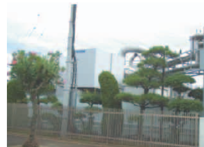
コージェネレーション施設
