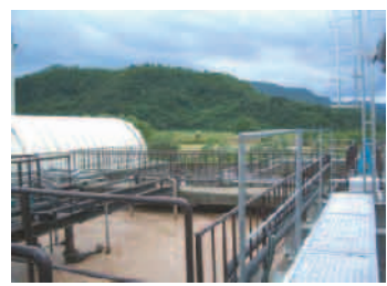
排水処理施設
