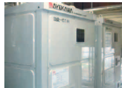
エコキュート設備
