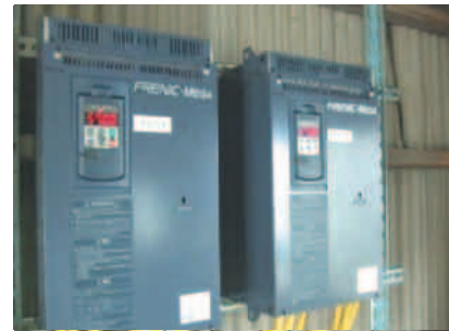
排水処理ブロワー用インバータ
