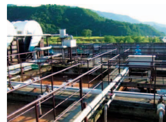
排水処理施設
