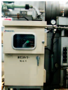
廃熱ボイラー
