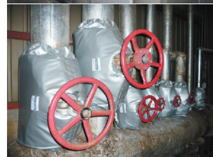
蒸気バルブの保温
