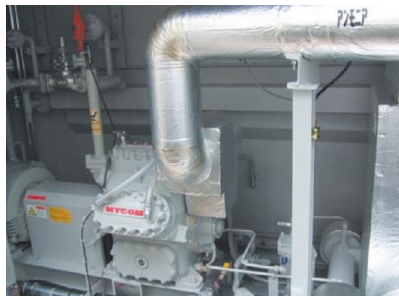
ノンフロン冷凍機
