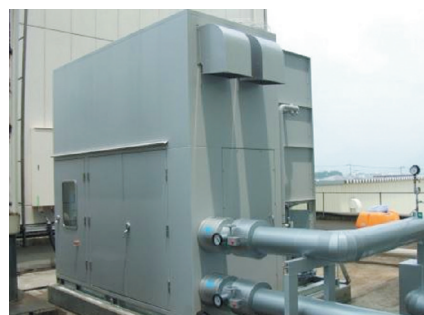
窒素フロン冷凍機
