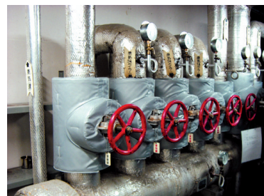
蒸気バルブの保温
