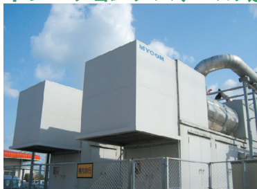
自家発電施設
