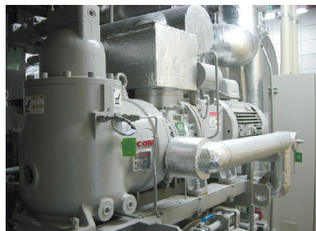
フロン冷凍機
