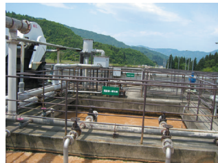
排水処理施設
