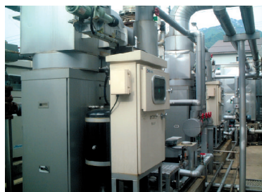
廃熱ボイラー
