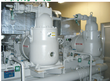
ノンフロン冷凍機
