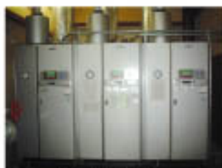
高効率ボイラー
