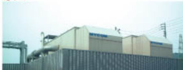
新潟魚沼工場発電施設
