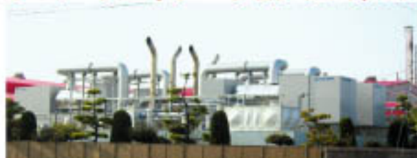
中央工場発電施設
